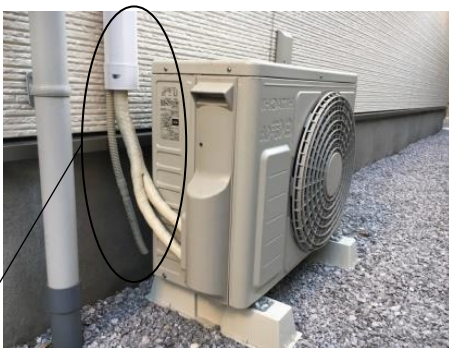
ドレンホース
